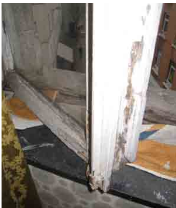
Chassis très vétustes, laissant passer pluie et vent.
