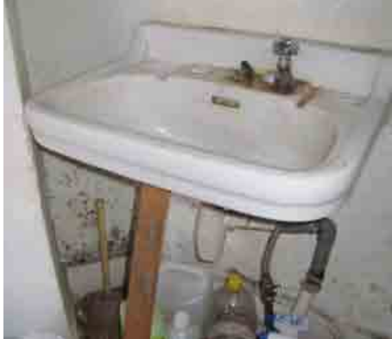
Évier sans eau chaude, juste maintenu par une planche en bois. Humidité sur les murs.
