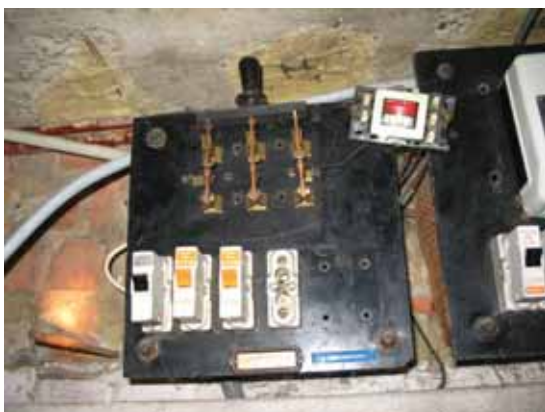
Interrupteurs à couteaux et absence de différentiels = danger de mort !
