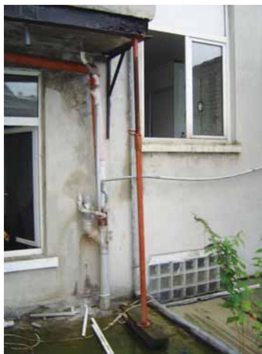
La maçonnerie de la salle de bain en encorbellement ne tient que grâce à un étai de chantier posé sur la toiture plate du logement du rez-de-chaussée.
