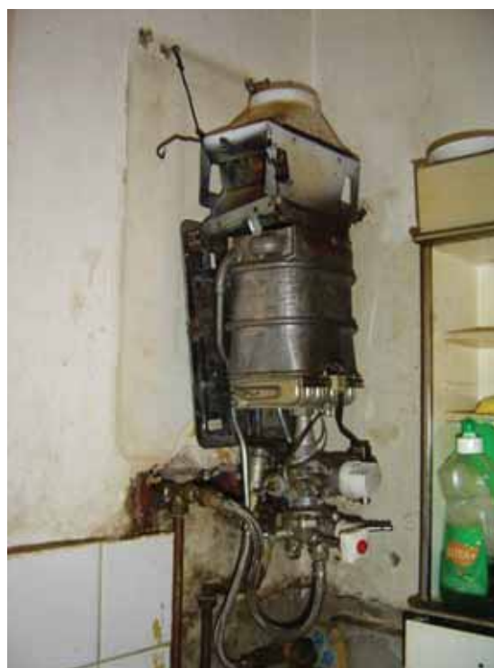
Sans évacuation et tenu par un fil, cet appareil était en fonctionnement avant le passage des inspecteurs
