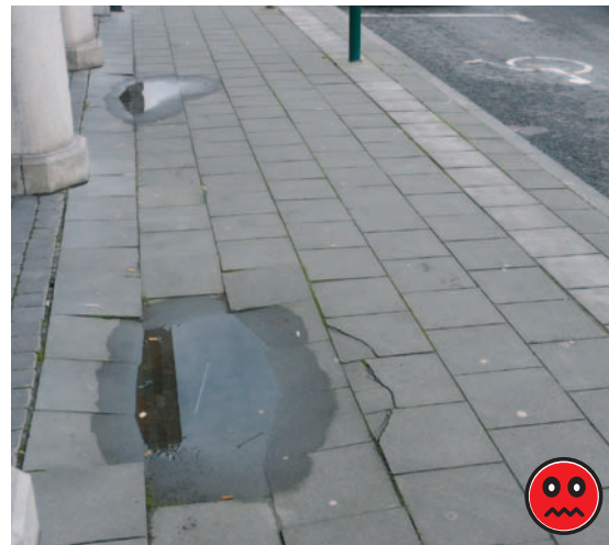
Évacuation des eaux de surface déficiente
