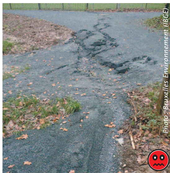
Problématique de ravinage sur des revêtements non stabilisés
