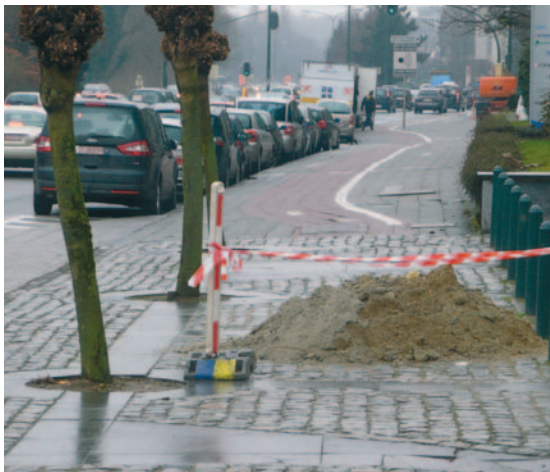
La remise en état du revêtement après intervention des impétrants est primordiale
