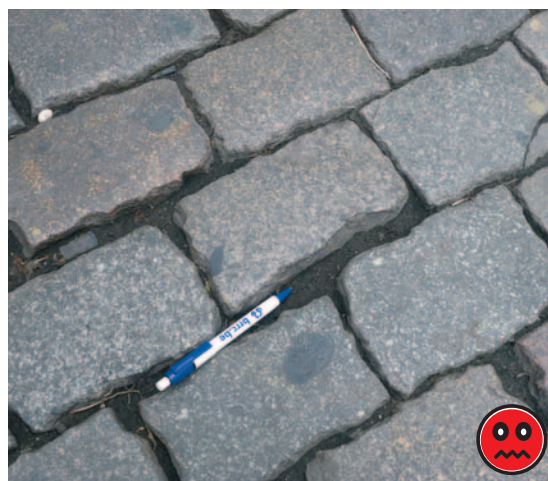
Joints trop larges et revêtement bombé
