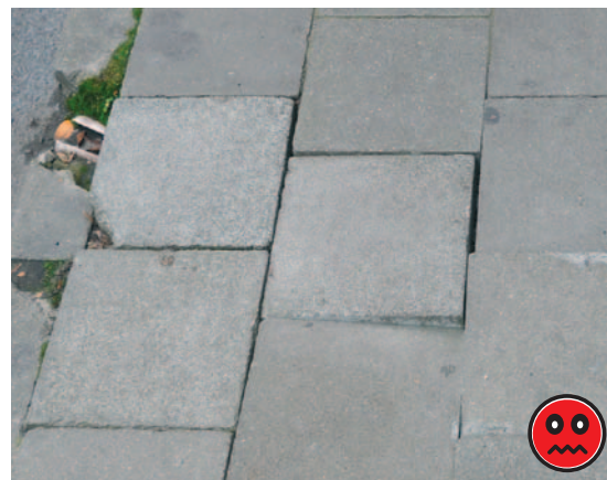
Descellement de plusieurs dalles devenues instables
