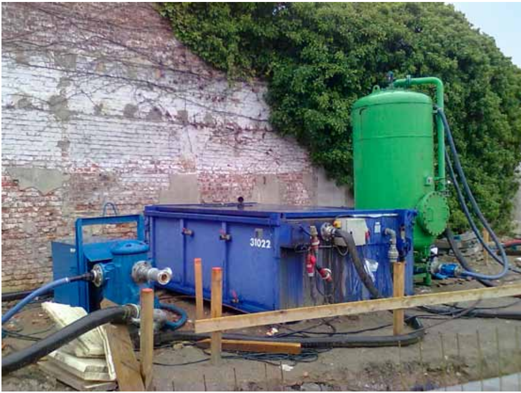
Système d'aspiration de l'eau souterraine polluée. Systeem voor de extractie van verontreinigd grondwater.
