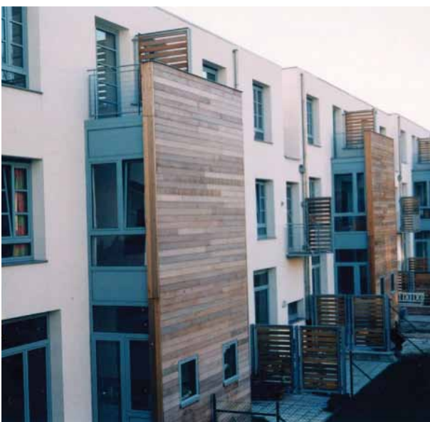
Wooncomplex in de Verrept Dekeyserstraat in Molenbeek, te bekijken tijdens de wandeling ARCHI-AUDIO (1999-2003). De bepleistering werd slecht uitgevoerd en nooit opgeleverd. Arch. Pierre BLONDEL
