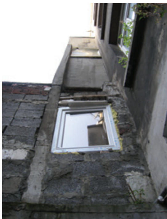
Zorgwekkende stabiliteit van dit bijgebouw
