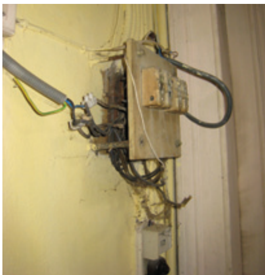
Levensgevaar door elektrocutie
