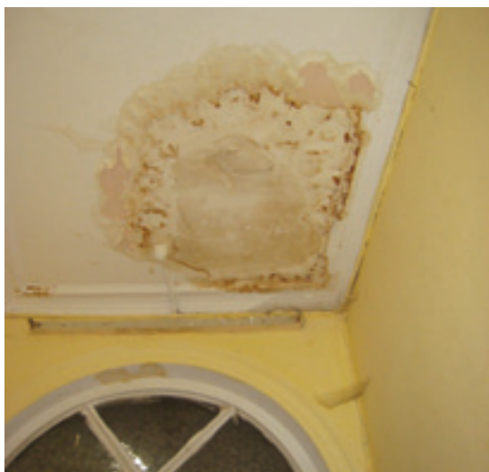
Resultaat van waterinfiltratie in plafond van inkomhal
