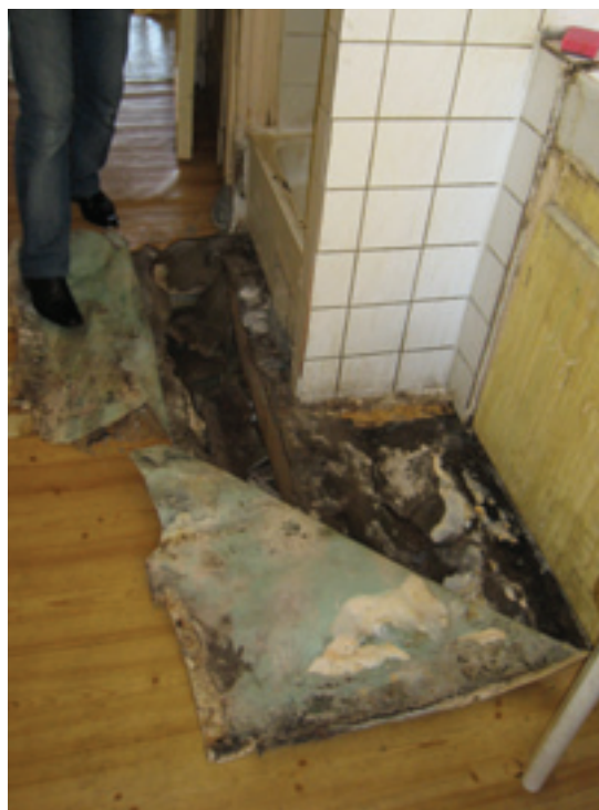
Vloerverzakking als gevolg van waterinfiltratie
